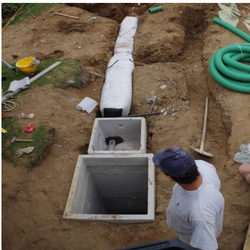
Figura 6. Visione d'insieme IDROSAC IMHOFF e pozzetto di smaltimento
