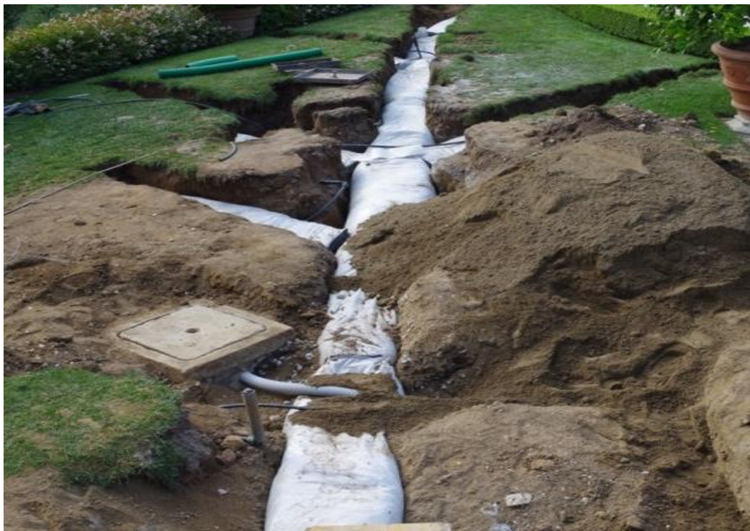
Figura 8. Vista di insieme dell'impianto di smaltimento con IDROSAC IMHOFF 500
